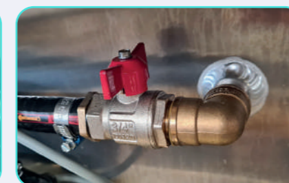
Monterad kulventil och slangnippel 3/4" matningsanslutning
