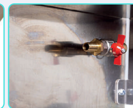
Monterad kulventil och slangnippel 3/4" matningsanslutning
