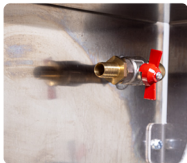
Monterad kulventil och slangnippel 3/4" matningsanslutning.
